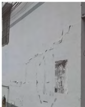
图7 严重破坏的自建砖房(承重砖墙穿透性裂缝)
