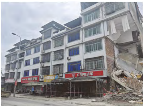
图6 完全坍塌的自建砖房
